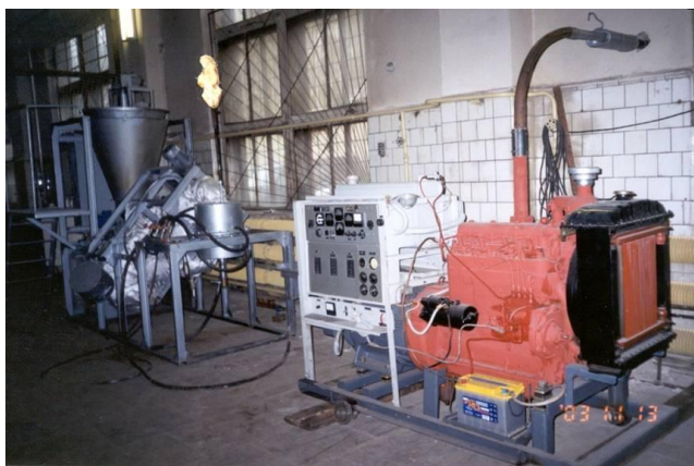
Рис. 2. Общий вид установки для получения жидкого и газообразного топлива (слева), производительность 0,5 т/сутки и дизель-генератор (справа) электрической мощностью 20 кВт
